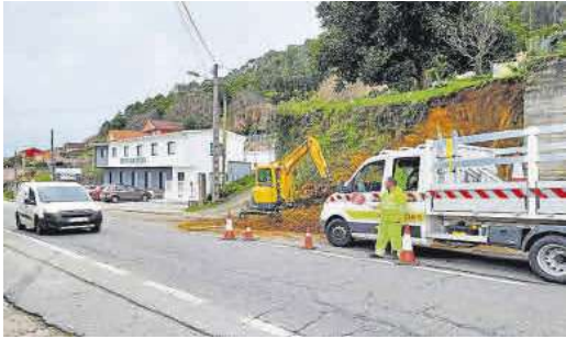
Desprendimientos sobre la PO-551 en A Madalena. | FdV
