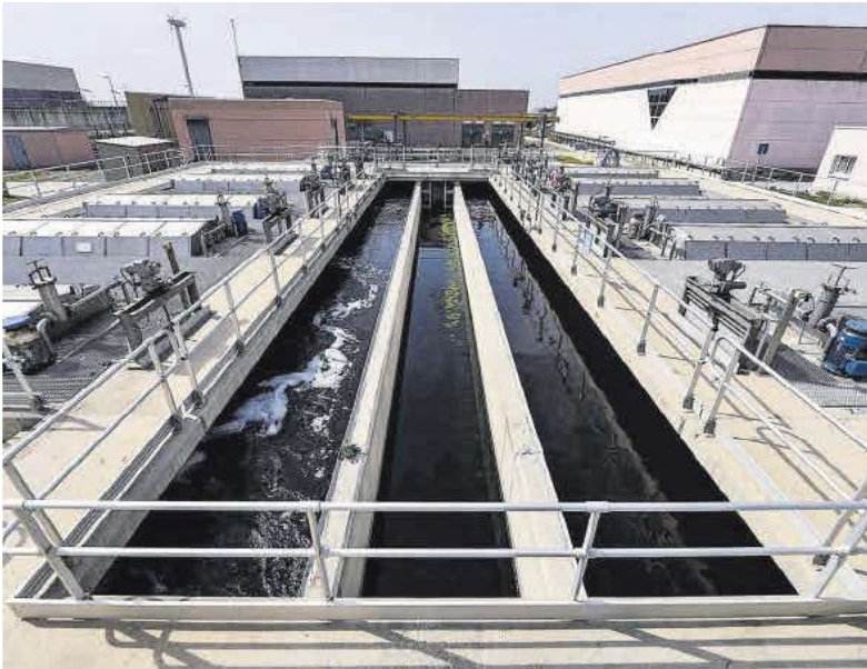
Depuradora de El Prat de Llobregat.
