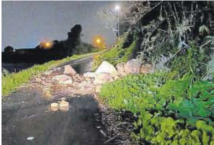
Desprendimiento de talud en O Latón. | FdV
