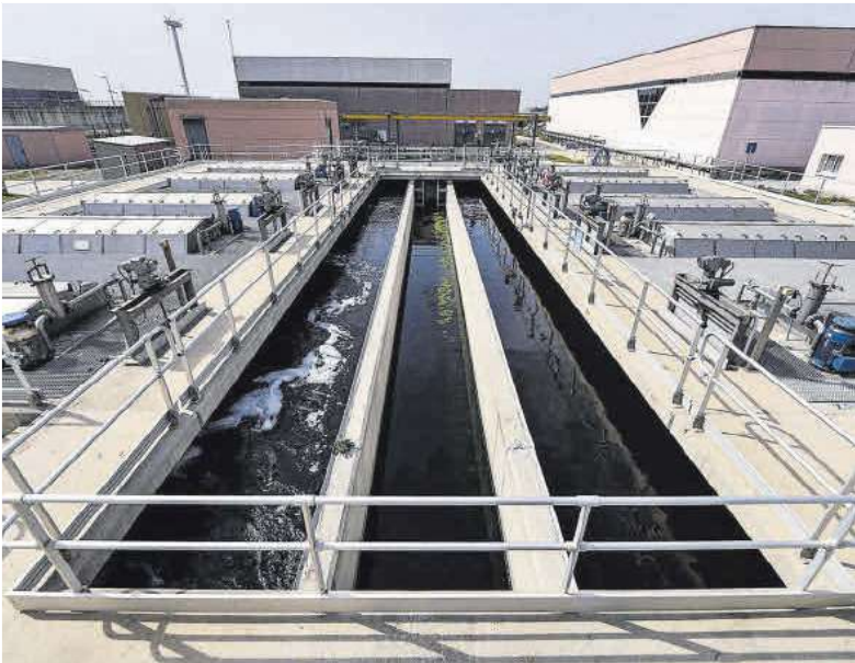
Depuradora del Prat de Llobregat.
